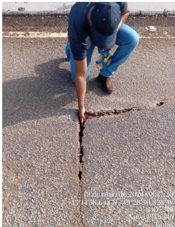
Figura 3 - Rachadura na ponte do Rio Pintado.
