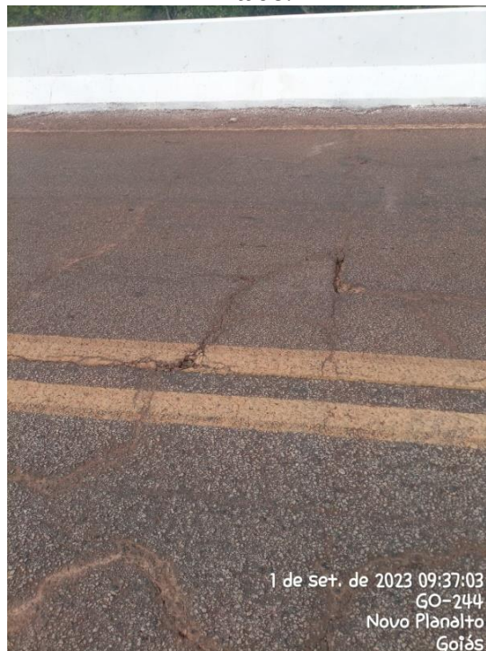
Figura 4 - Trinca na ponte do Rio Pintado.
