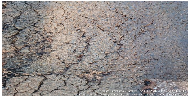
Figura 3: Trinca couro de jacaré.
