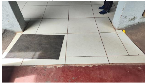
Figura 7: Desnível sem piso tátil
