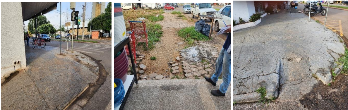
Figura 1: Falta de manutenção
