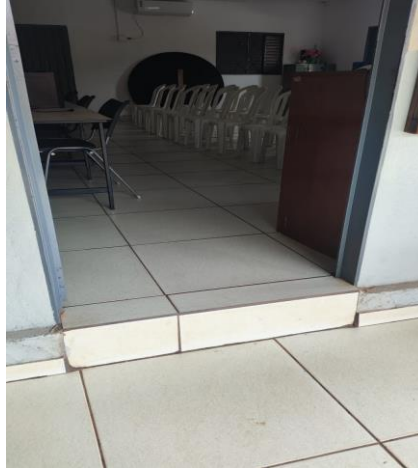
Figura 9: Entrada do auditório sem rampa de acesso
