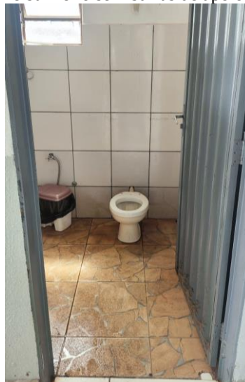
Figura 10: Vaso impróprio para cadeirantes e banheiro sem barras de apoio
