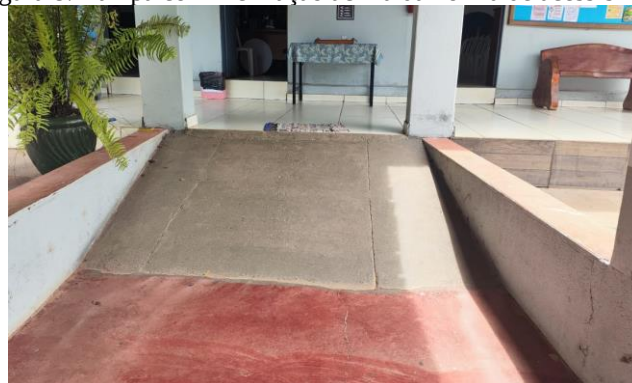
Figura 8: Rampa com inclinação acima da norma de acessibilidade
