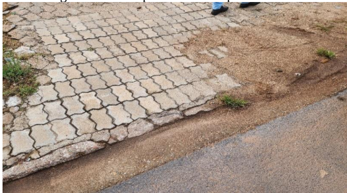
Figura 5: Piso trepidante em rampa desnivelada
